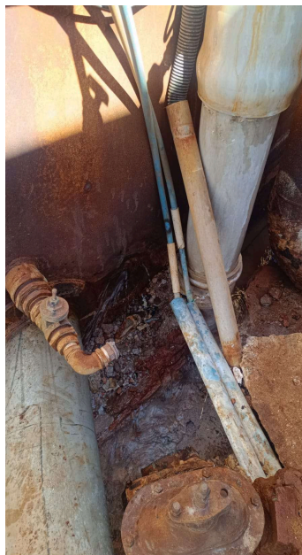
Foto 11 - Vazamento costado sucção
