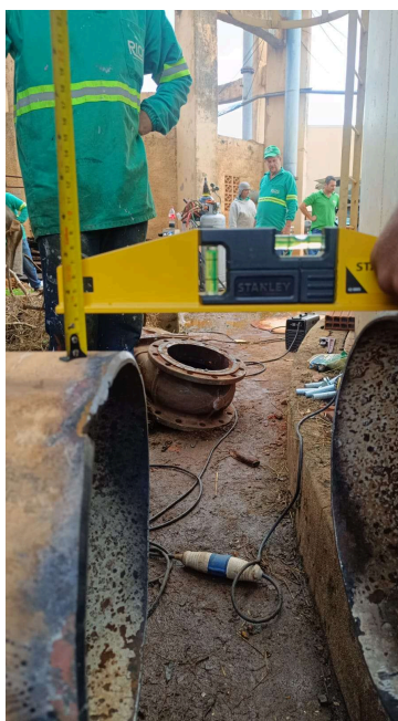
Foto 5 - Situação válvula transferência
