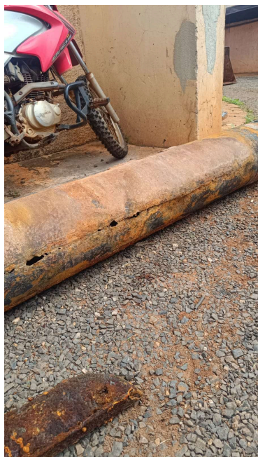
Foto 6 - Situação Tubo Sucção
