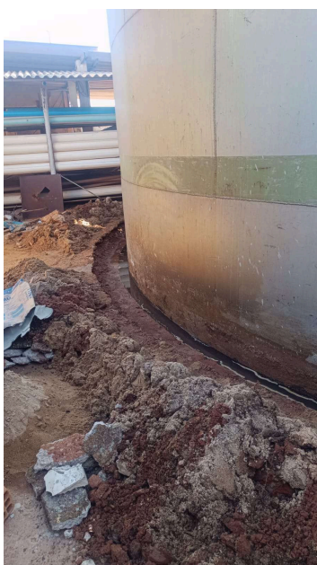
Foto 10 - Inspeção vazamento costado
