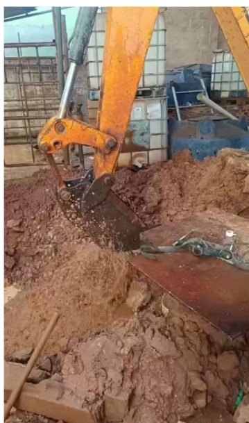
Foto 18 - Vazamento P04 após inspeção
