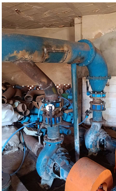
Foto 45 - Adequação sentido de recalque, válvula borboleta, válvula de retenção
