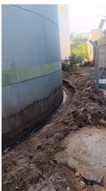
Foto 9 - Inspeção vazamento costado
