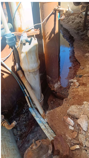
Foto 14 - Vazamento costado sucção
