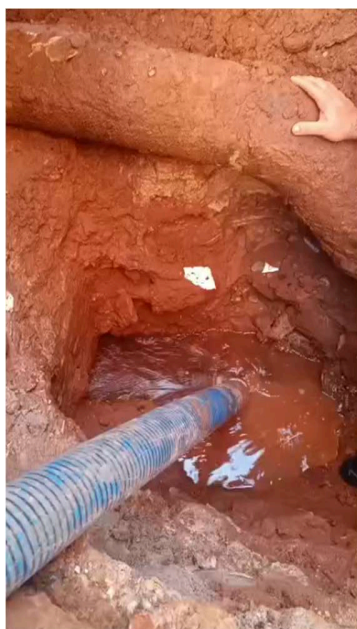
Foto 22 - Vazamento P04 após inspeção
