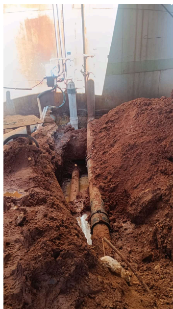
Foto 21 - Vazamento P04 após inspeção
