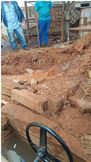
Foto 16 - Vazamento P04 após inspeção
