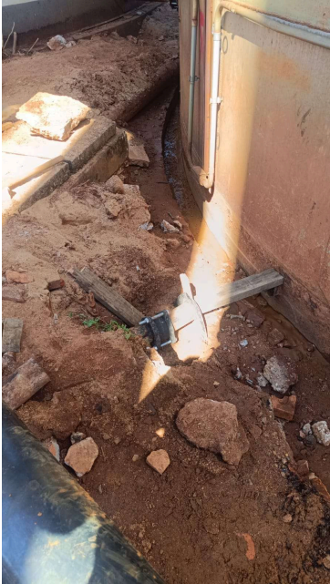
Foto 24 - Dreno com vazamento oculto
