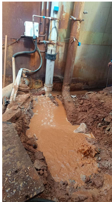
Foto 15 - Vazamento EAT01 após inspeção
